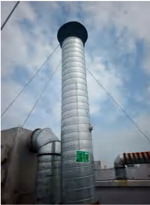
密炼、注塑、开炼废气排放口照片
