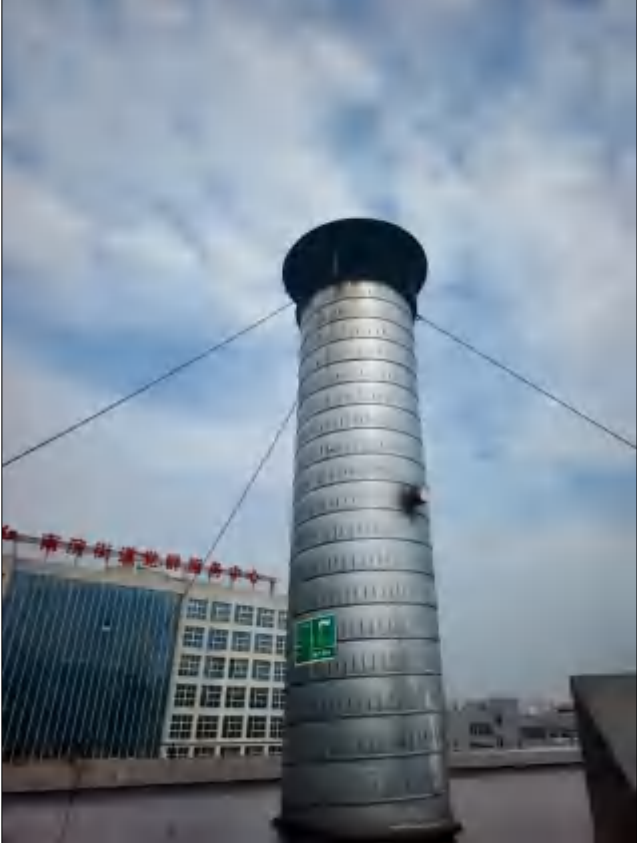
吹塑、挤出、硫化废气排放口照片
