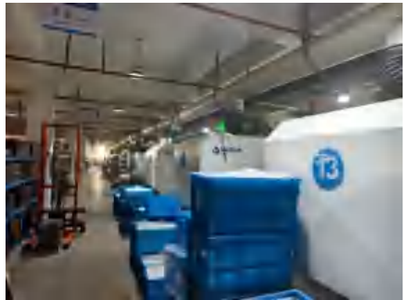
注塑废气集气照片
