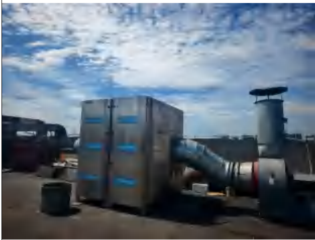
活性炭吸附处理设施照片
