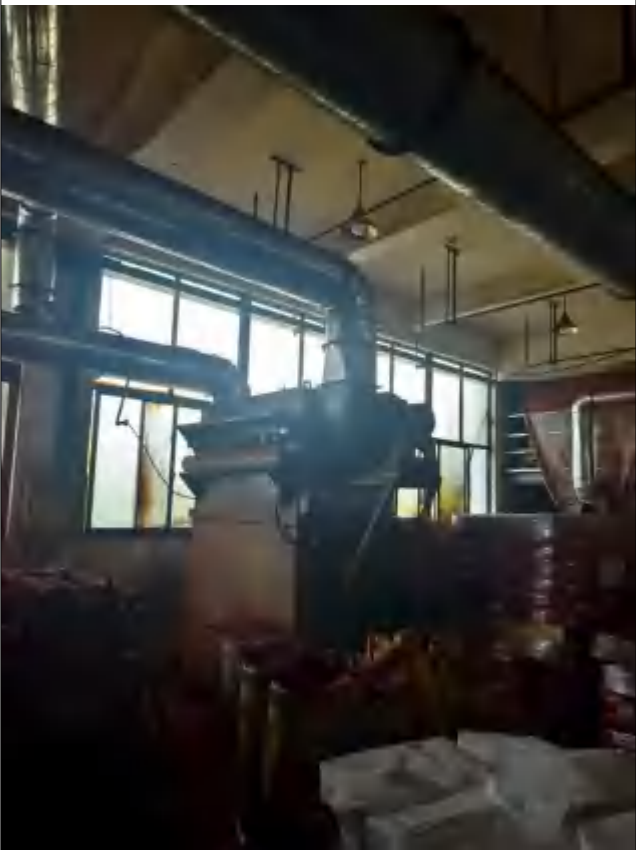
3#布袋除尘设施
