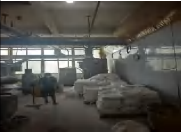
1#布袋除尘设施
