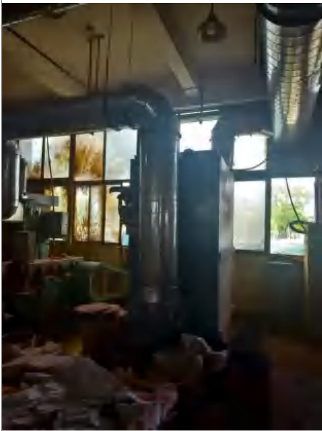
2#布袋除尘设施
