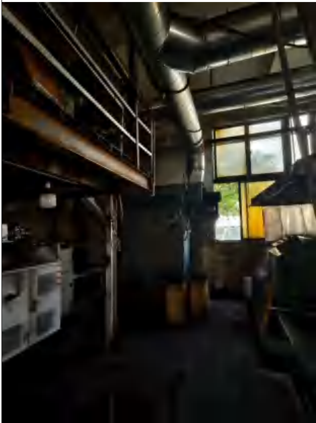
4#布袋除尘设施
