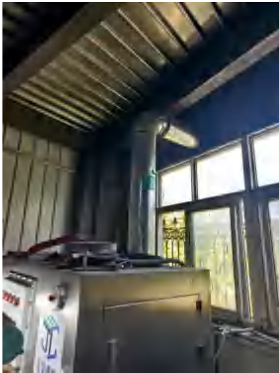
抛丸粉尘废气排气筒照片
