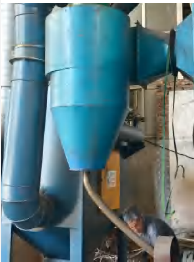
1#抛丸机自带处理设施照片
