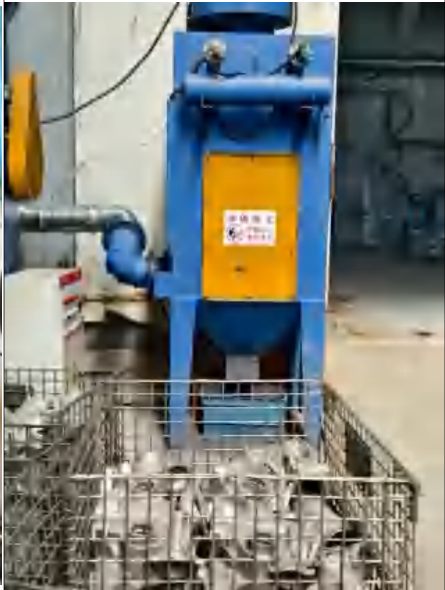
2#抛丸机自带处理设施照片
