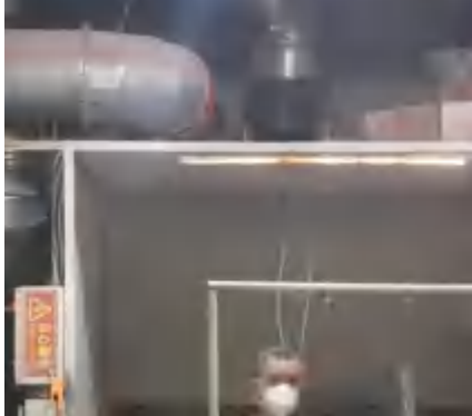
喷塑废气集气照片
