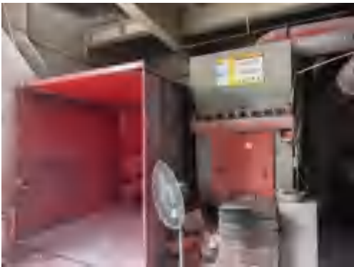
喷塑废气集气及处理设施照片
