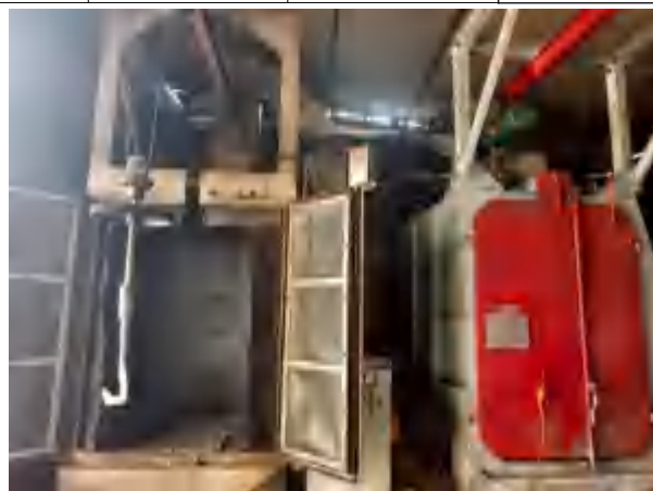
抛丸废气集气照片
