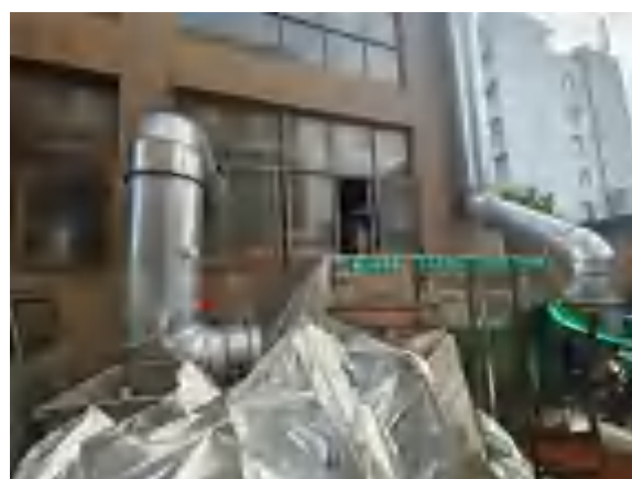
喷漆废气除雾+活性炭吸附设备照片
