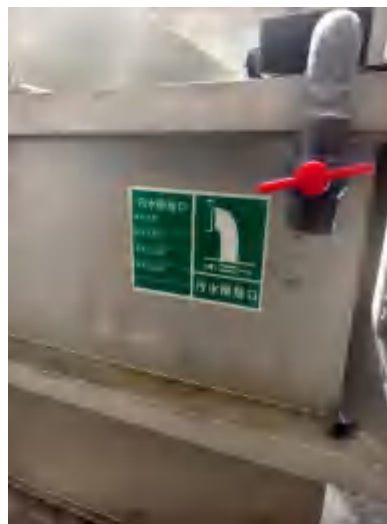
废水排放口标牌
