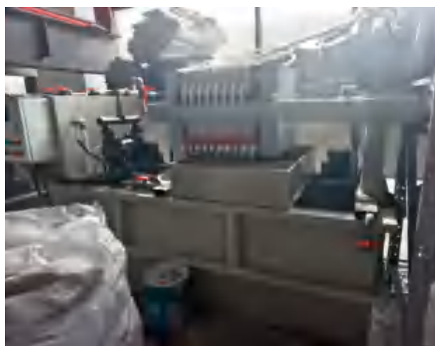
生产废水处理设施图
