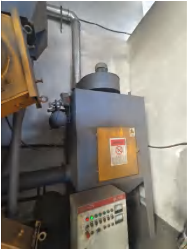
抛丸布袋除尘处理设施
