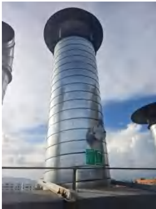
喷漆废气排气筒照片
