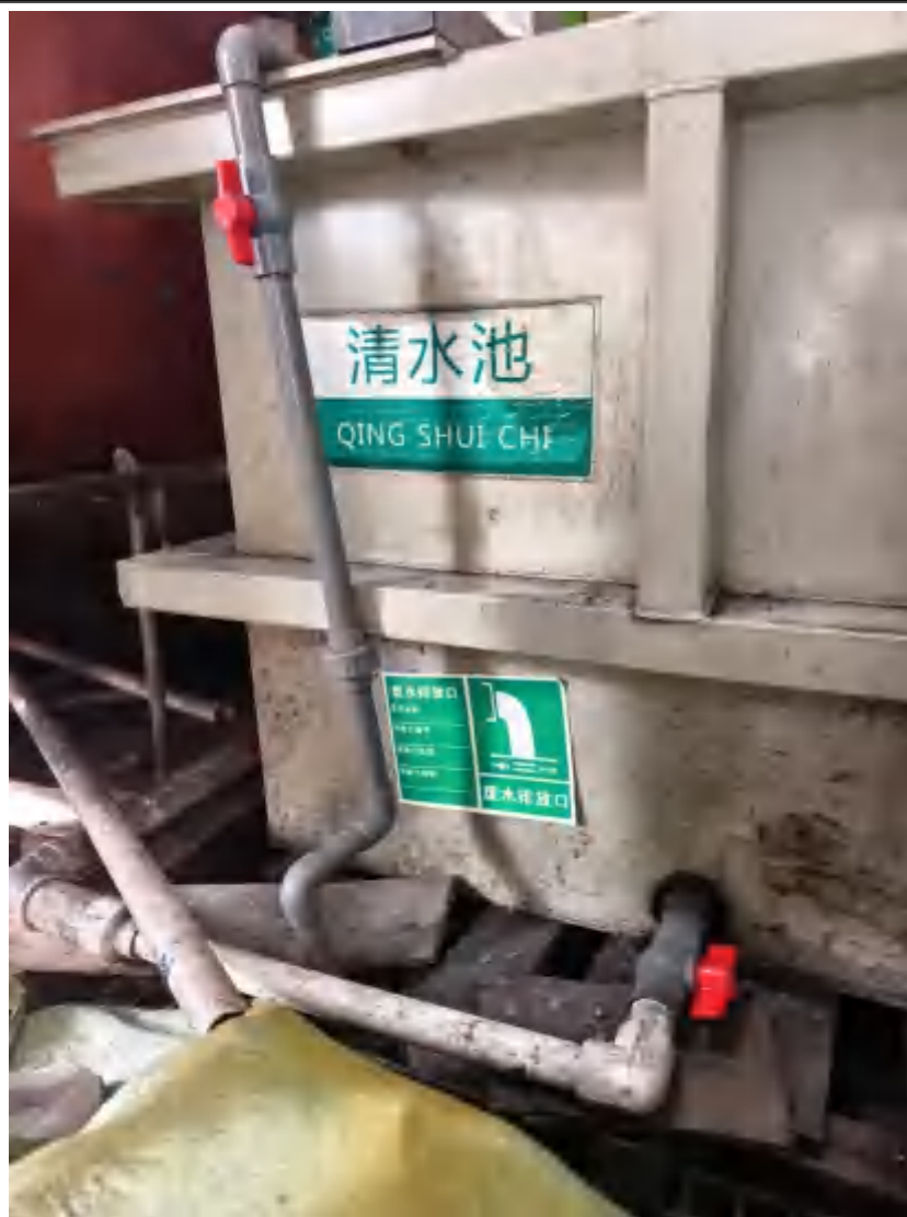
废水排放口标牌
