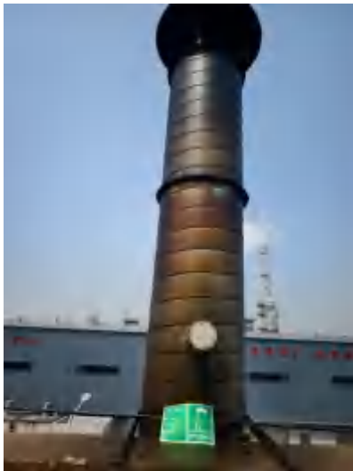
淬火、回火废气和滚丝废气排放口
