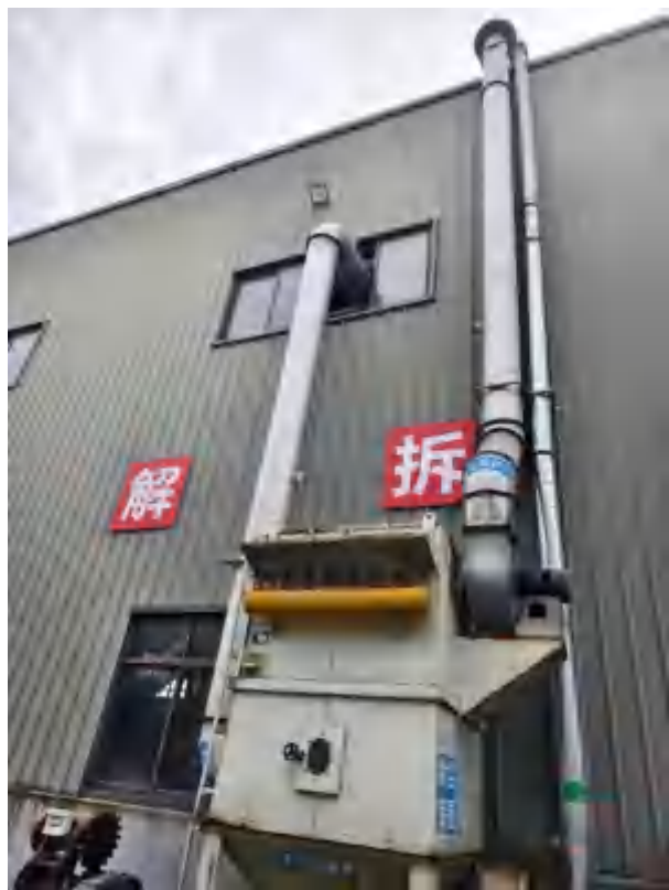
布袋除尘装置及排气筒照片
