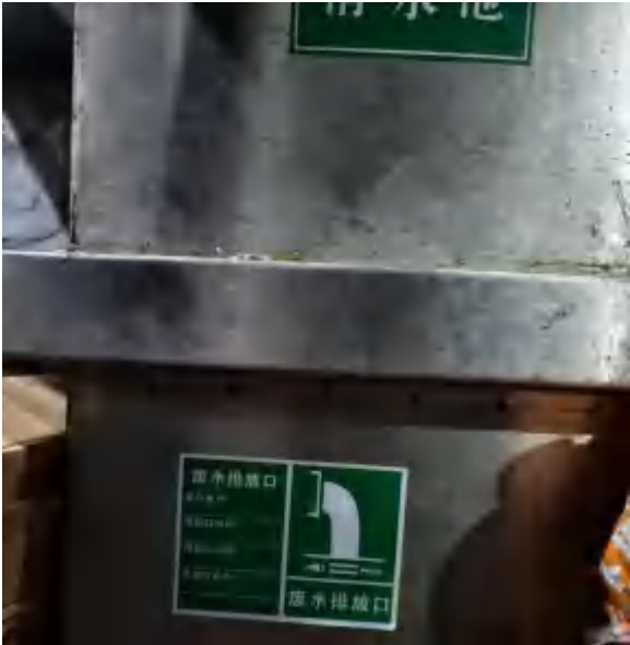
废水排放口标牌
