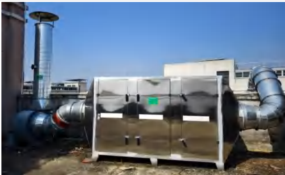
激光切割废气活性炭吸附设施
