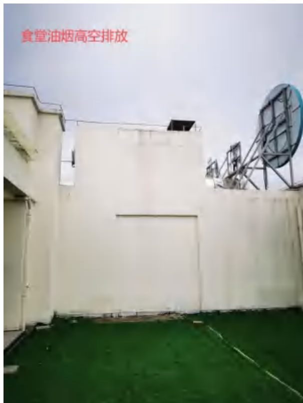
食堂油烟排气筒
