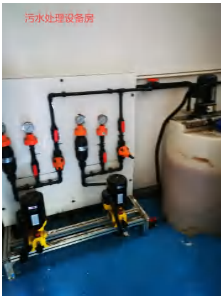
图3-2 废水处理设备照片
