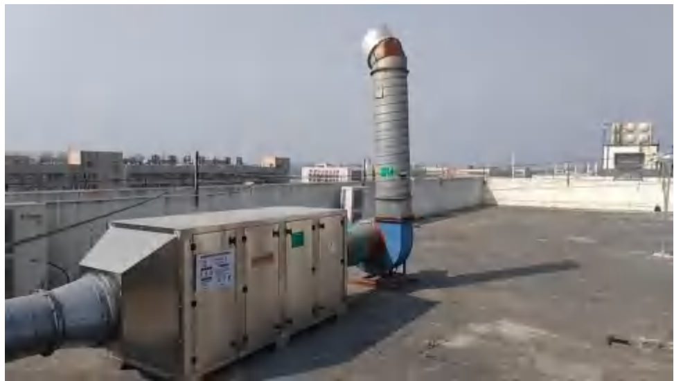
活性炭吸附设施和排气筒照片
