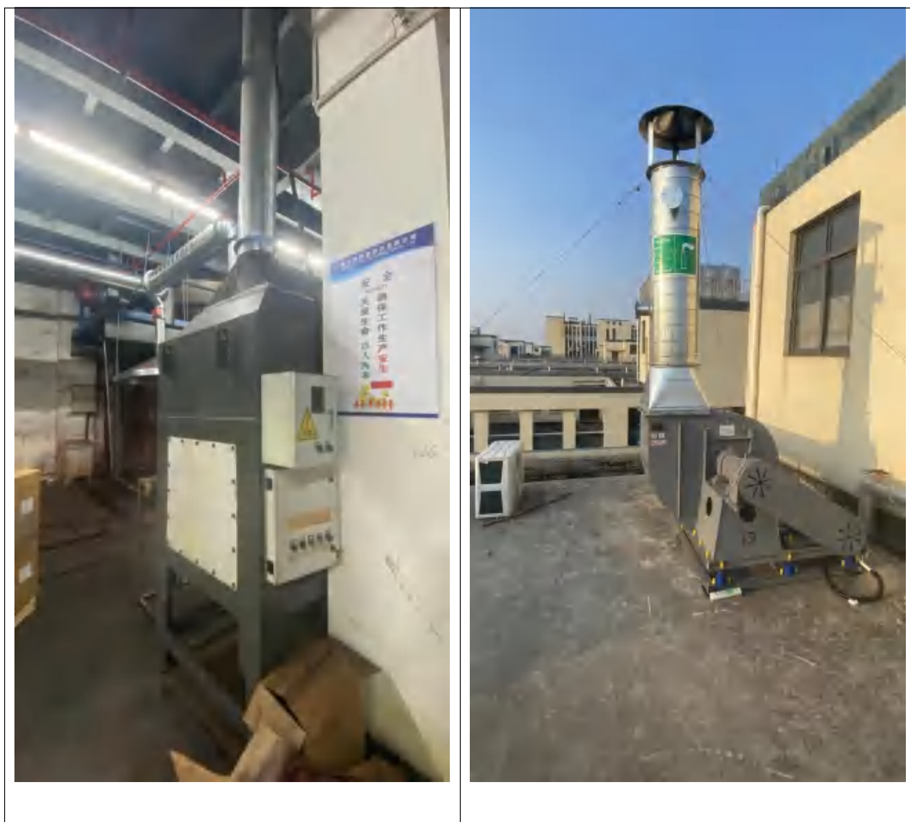
附图 4：废气和废水处理设备
