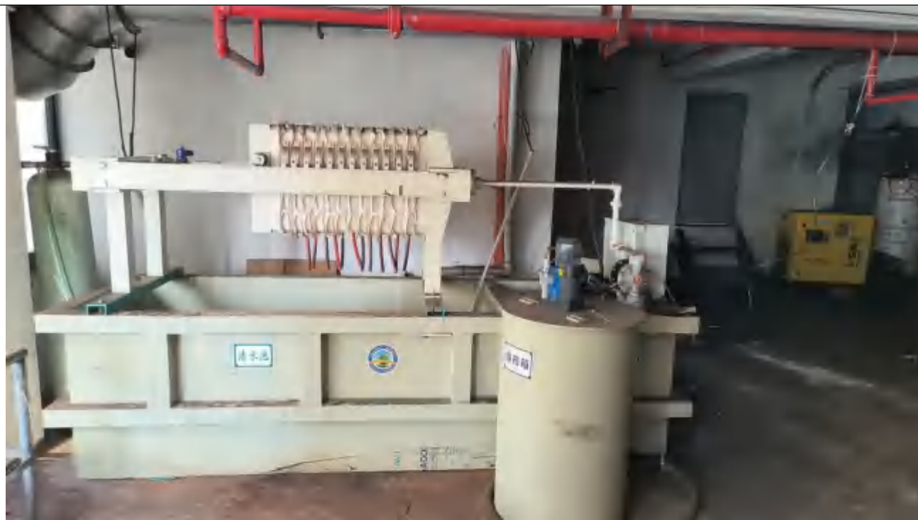
废水处理设施照片
