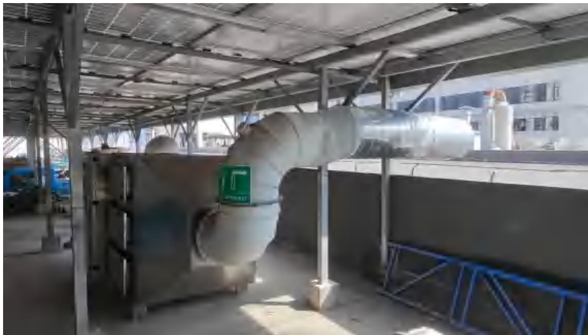
活性炭处理设备照片+排气筒标牌照片
