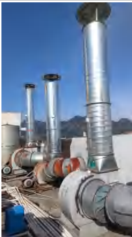
活性炭处理设备照片+排气筒标牌照片
