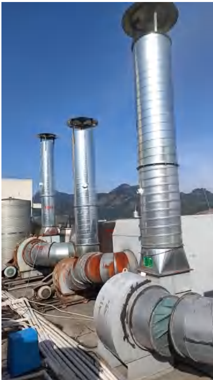
刷胶及烘干、喷光废气处理设施排气筒
