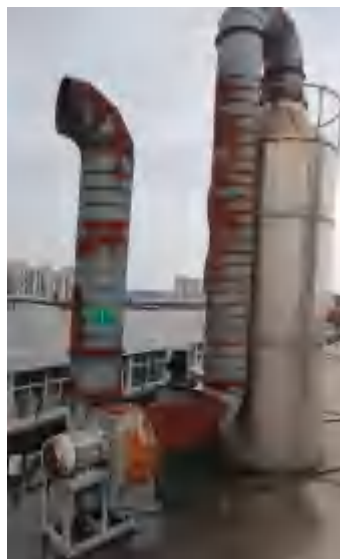
水喷淋设备+排放口标牌图片
