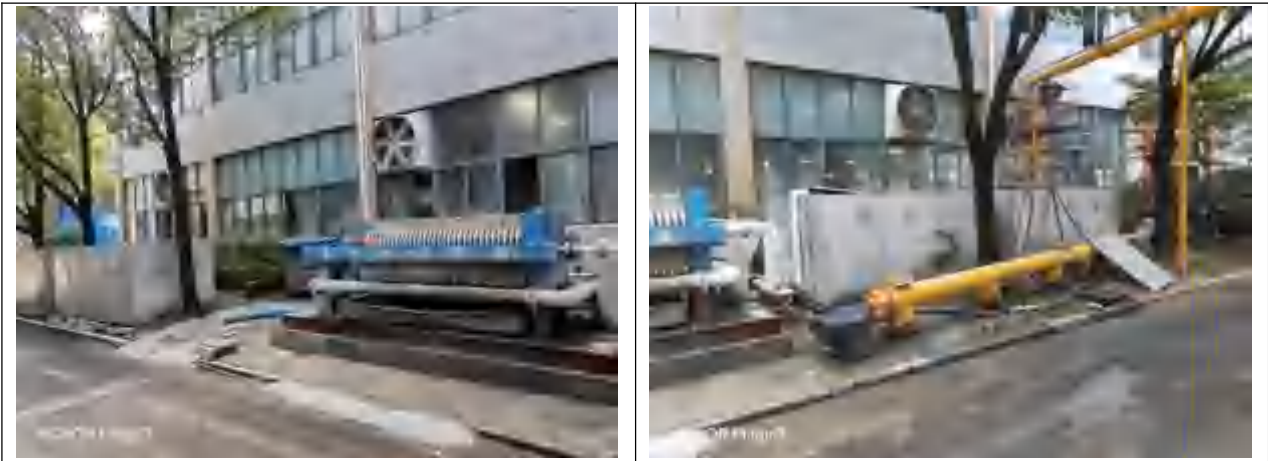
图3-3 生产废水处理设备照片
