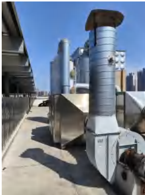
喷漆、晾干废气处理设备
