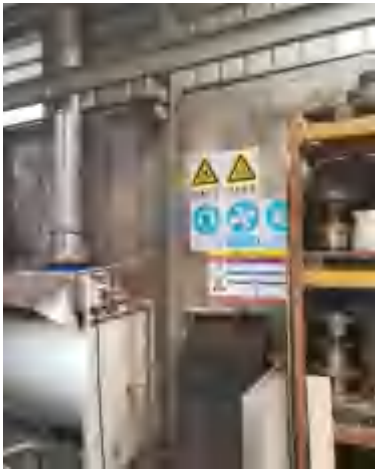
水帘除尘照片
