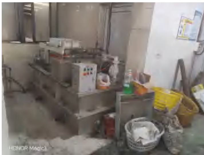
图3-2 废水处理设备照片
