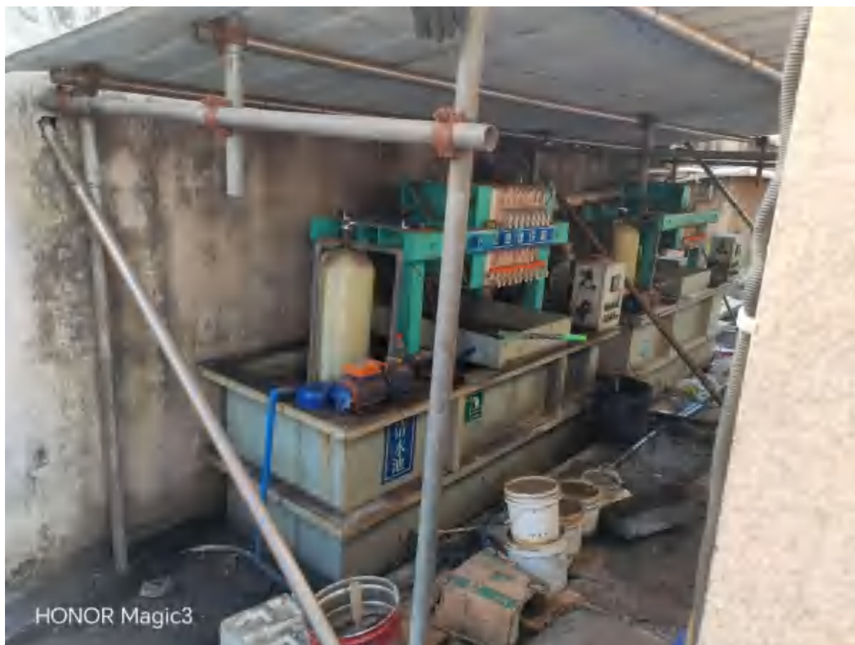
图3-2 废水处理设备照片
