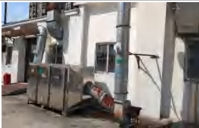
活性炭吸附设备照片（含废气排放口标牌）
