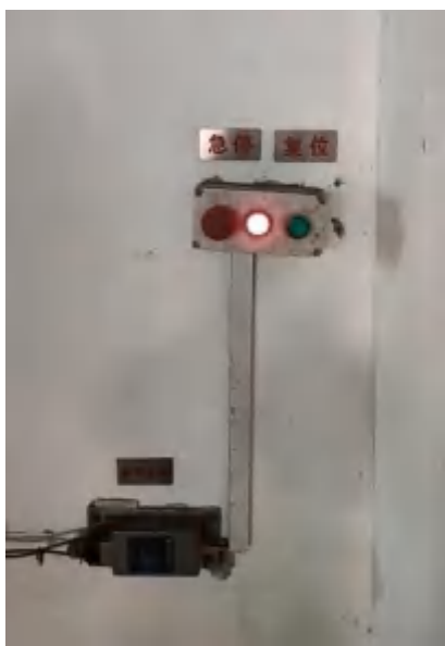
图6-16 拉线开关、急停按钮、复位按钮
