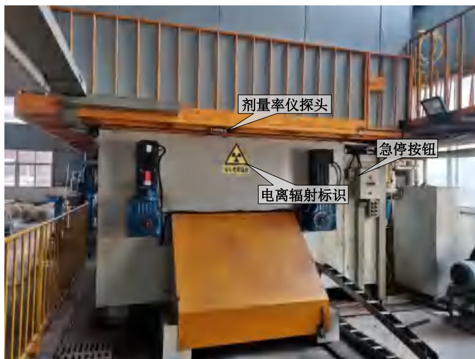
图6-5 0.8MeV自屏蔽电子加速器西侧 (电离辐射标识、警戒护栏、剂量率探头)
