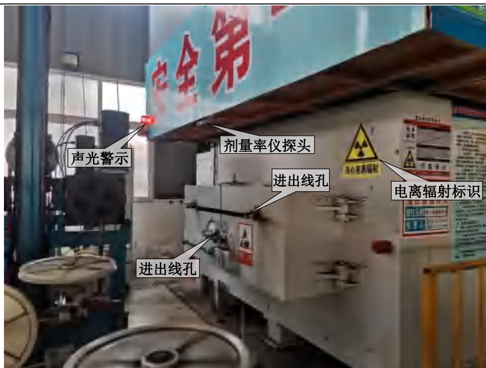
图6-6 0.8MeV自屏蔽电子加速器东侧 (进出线孔、电离辐射标识、剂量率探头、声光警示)
