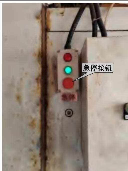
图6-2 自屏蔽电子加速器震荡柜急停按钮
