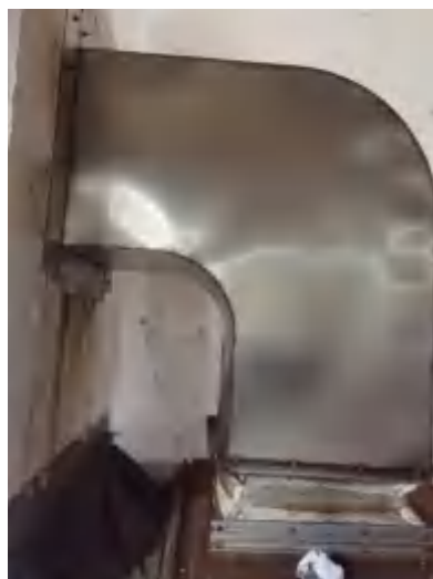
图6-24 七#机房排风风道
