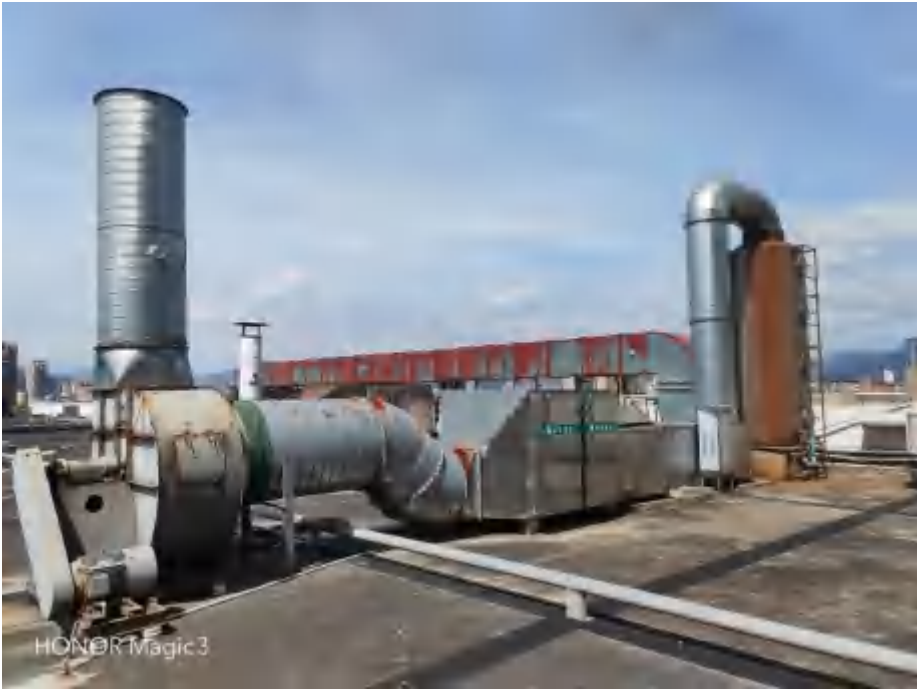
图 3-4 废气处理设备照片
