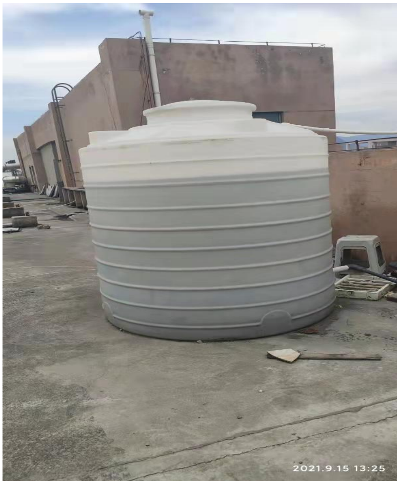
图3-2 废水处理设施图
