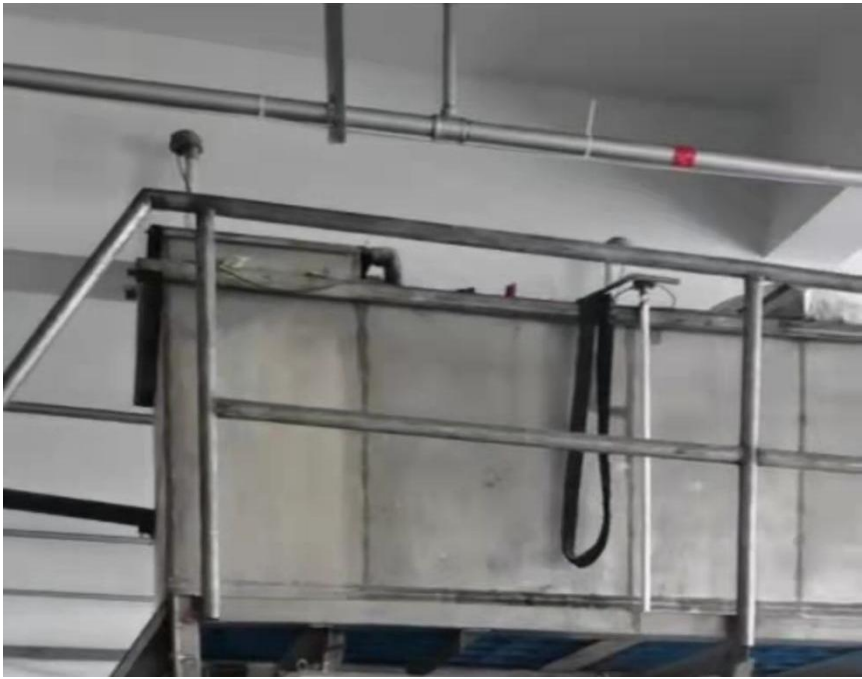
图3-2 自建污水处理设备图
